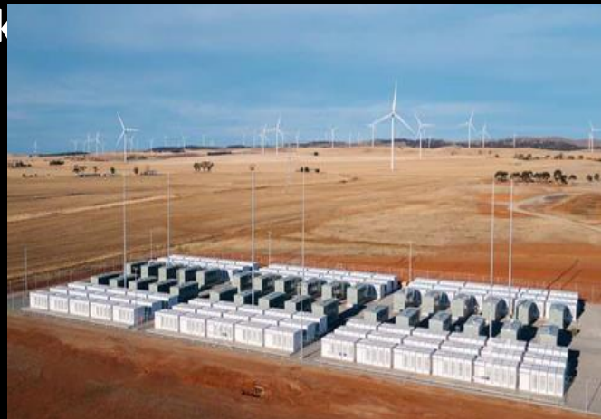
“Bateriová vesnice” Hornsedale, Austrálie, 0,13 GWh
